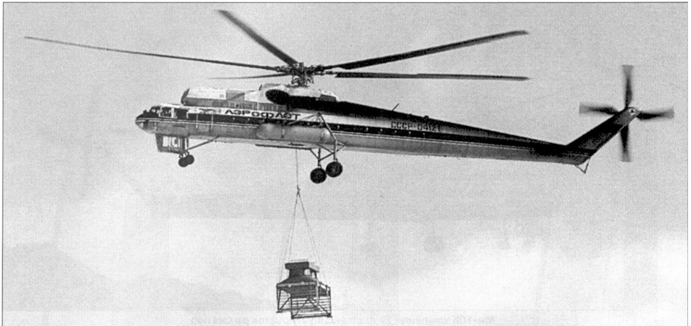
Тюменский Ми-10К доставляет к месту установки элемент вентиляционной системы The Mi-10K, operated in Tumen, is transporting a unit of ventilation system to the place of mounting
