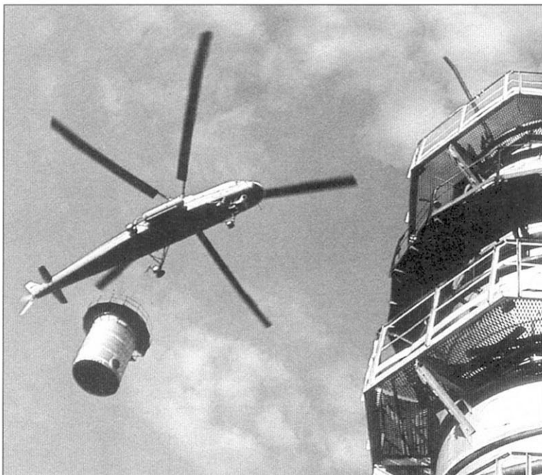
Ми-10К во время монтажа очередного объекта The Mi-10K fulfils its usual work on assemblage
