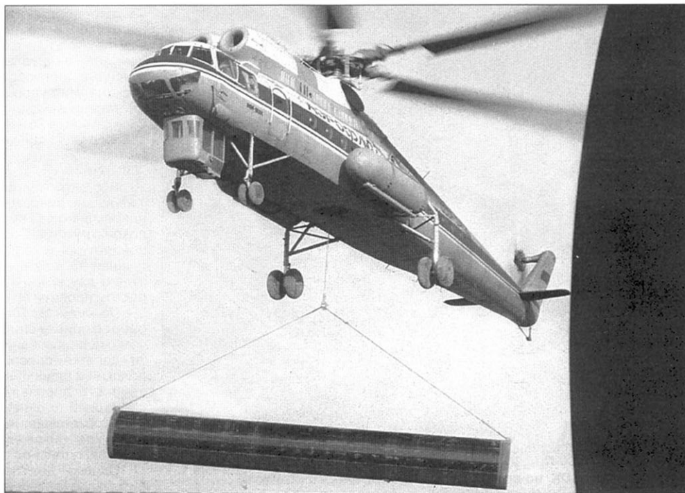
Ми-10К немало потрудились на прокладке магистральных трубопроводов The Mi-10Ks hardly worked on laying trunk pipeline
